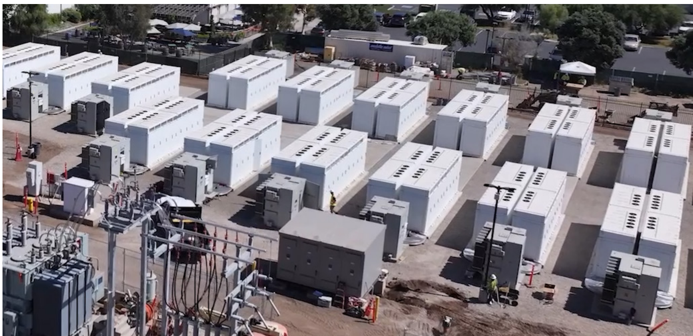
Goleta Energy Storage | Tesla | Goleta, CA 60MW/160MWh (44 Tesla Megapacks)
