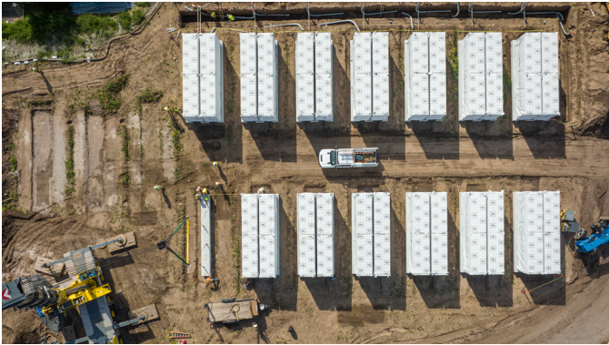
Goleta Energy Storage | Goleta, CA 60 MW BESS project 44 Tesla Megapacks BESS
